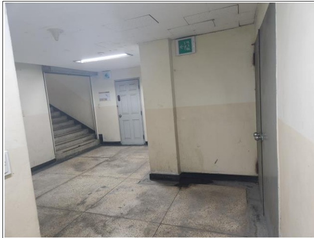
공용구간(복도, 계단실) 벽체 도장 + 도어 및 철재(서터등) 도장공사 포함 + 천장 기존천장(석고보드)위 도장공사 포함 (바닥은 공사제외)
