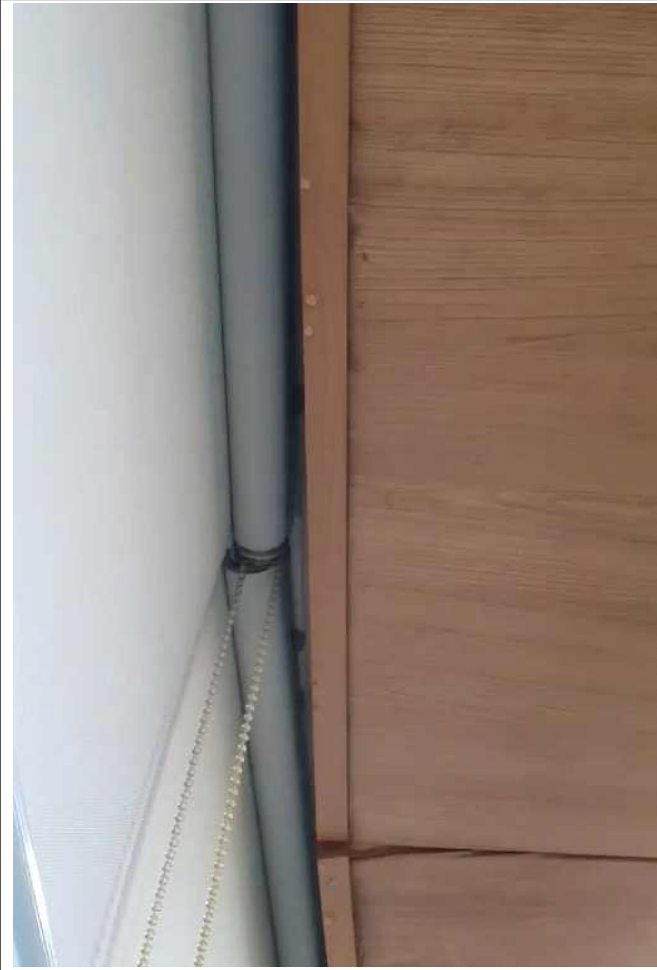
상록원 3층 누수 사진(빗물)
