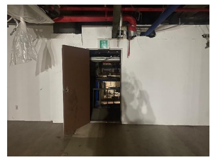
기계실 연결 출입문
