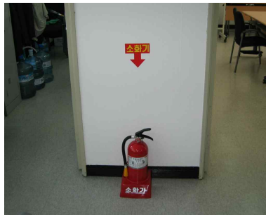
소화기표지 설치상태 점검
