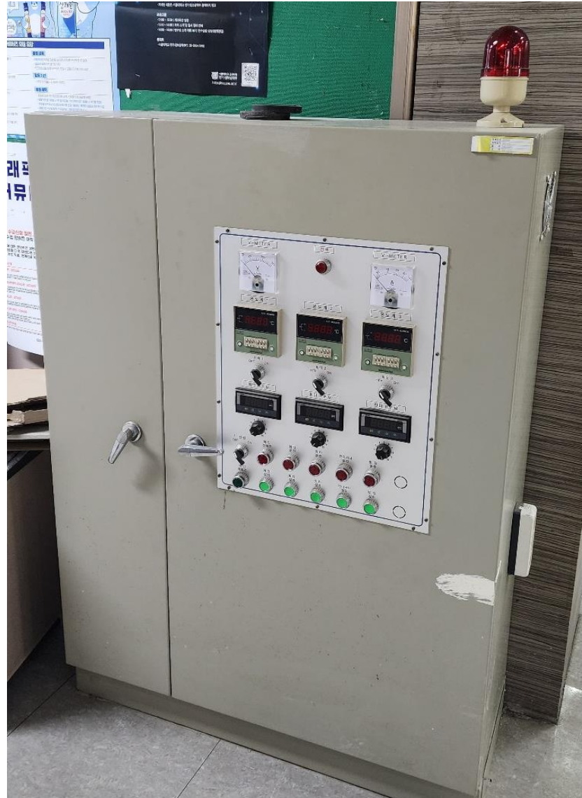
실험보조장비 사진1 (실험주장비 전원공급 및 컨트롤 박스)
