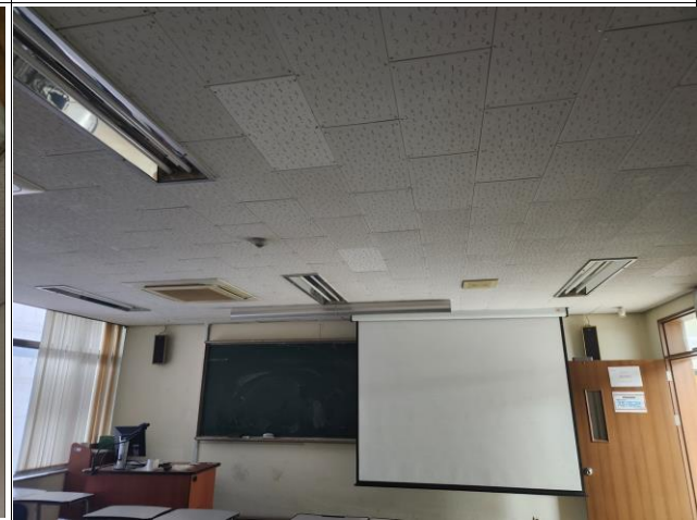
학술관 3F 석면철거 및 천장시공 (LED, 스피커, 감지기, 스크린 등 임시철거후 재설치 / EHP 및 각종 장비 보양 / 형광등 철거)
