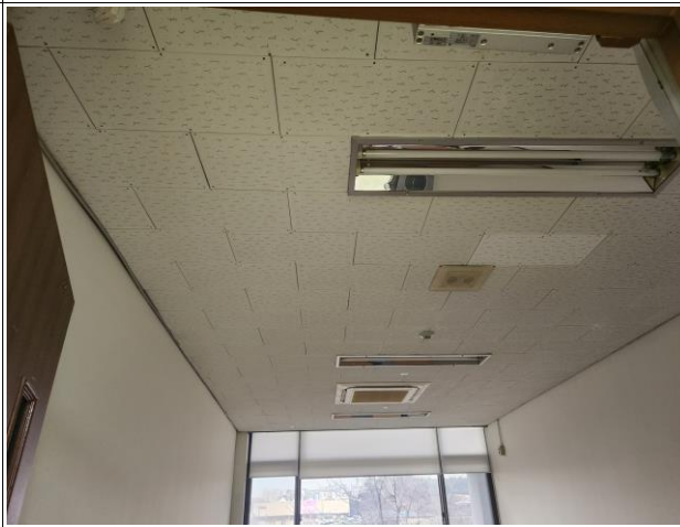
학술관 3F 석면철거 및 천장시공 (LED, 스피커, 감지기 등 임시철거후 재설치 / EHP 및 각종 장비 보양 / 형광등 철거)
